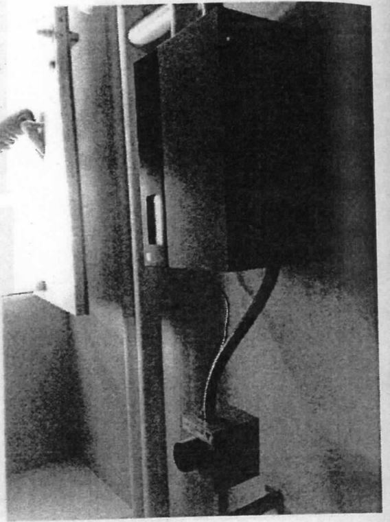
◁ 溫庫・通風設備 ▷
